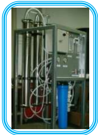
SISTEMA DE OSMOSIS INVERSA
